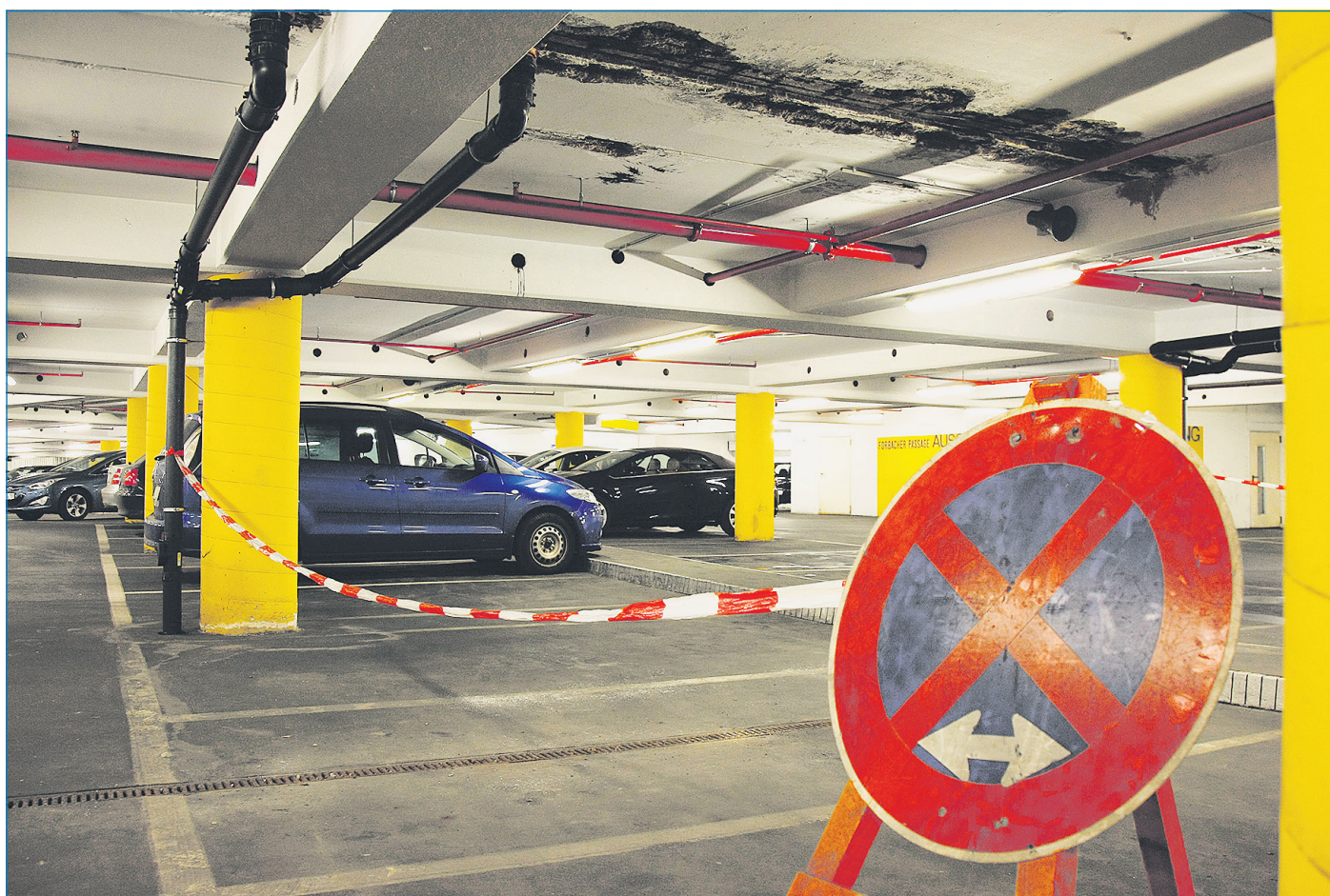
In der City-Tiefgarage müssen Betonflächen saniert werden.
